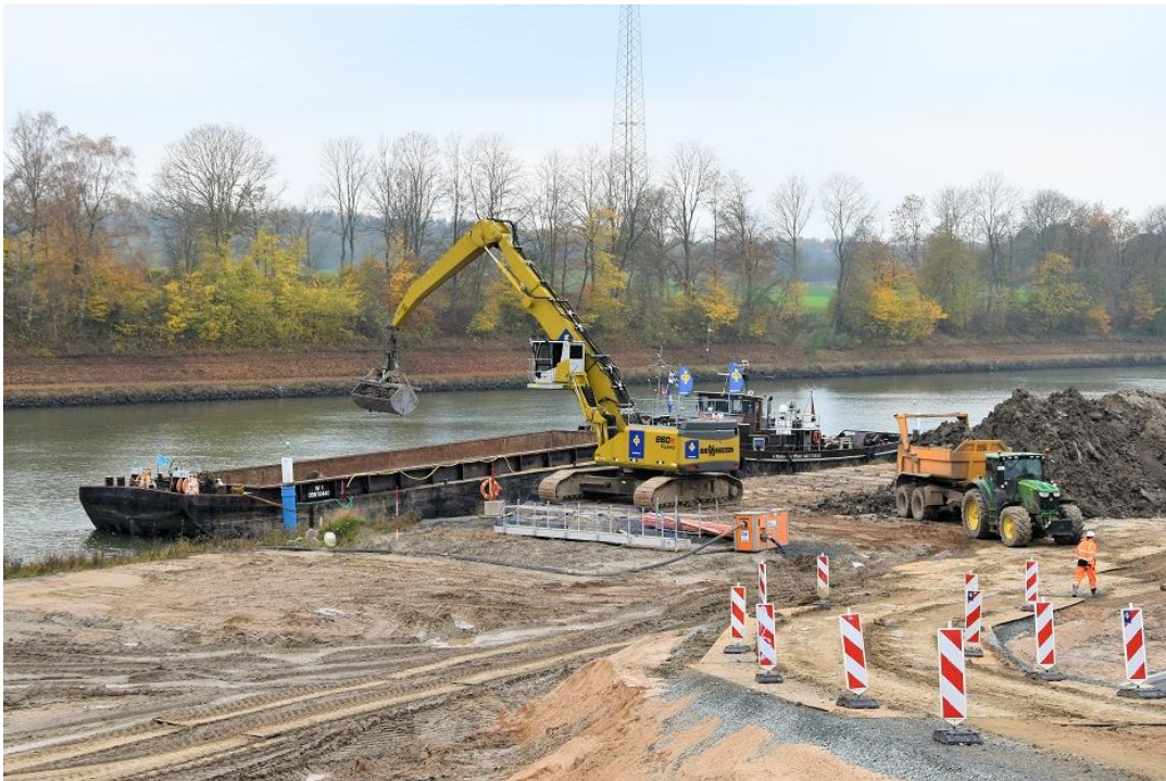
Temporärer Schiffsanleger zum Transport von Boden und Materialien für den Bau des neuen Deckwerks
