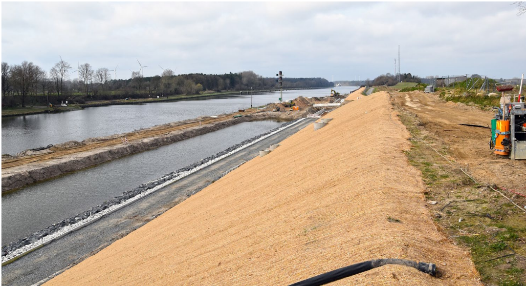
Westlicher Abschluss des ersten Bauabschnitts bei der Weiche Königsförde mit befestigter Böschung (Stand: März 2024)
