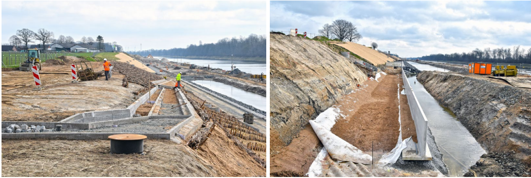
Arbeiten in der Bauzone A an einem Verbindungsweg für Fußgänger und Radfahrer hoch zum Eiderredder sowie am neuen Betriebsweg (Stand: März 2024)
