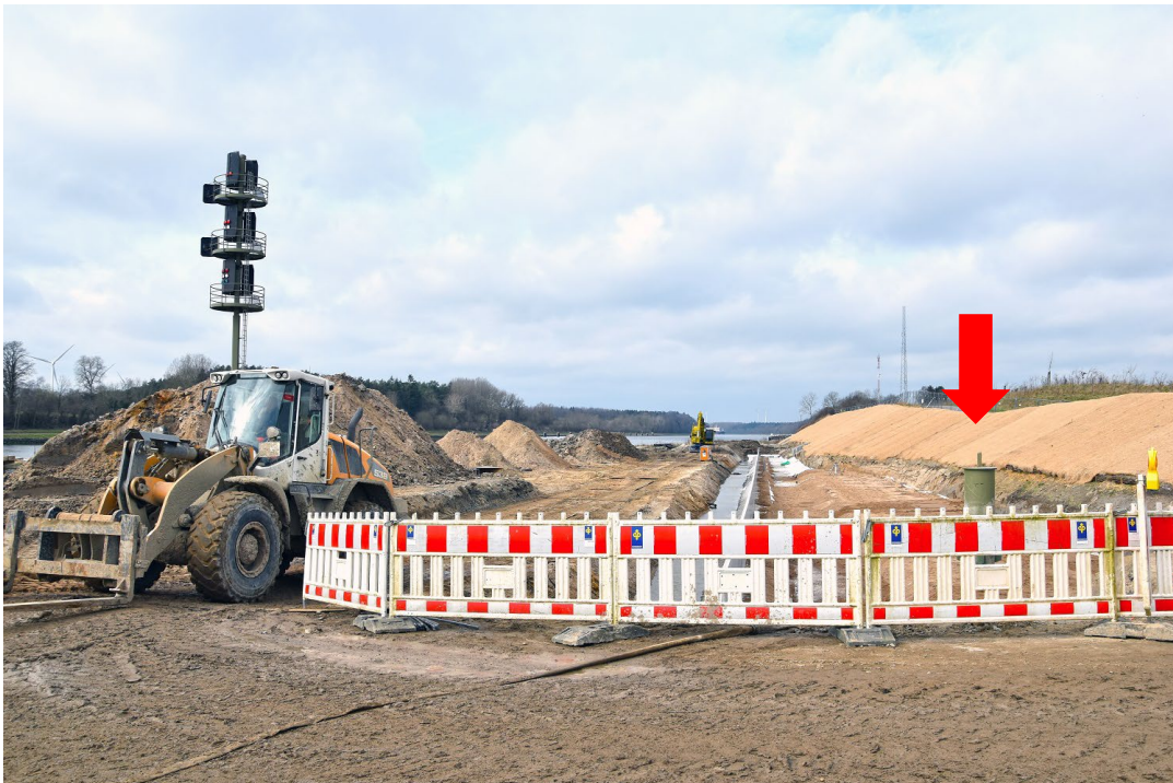
Der Signalmast wird im Frühjahr 2024 nordwärts versetzt. Das Fundament am neuen Standort (roter Pfeil) ist schon fertig (Stand: März 2024).
