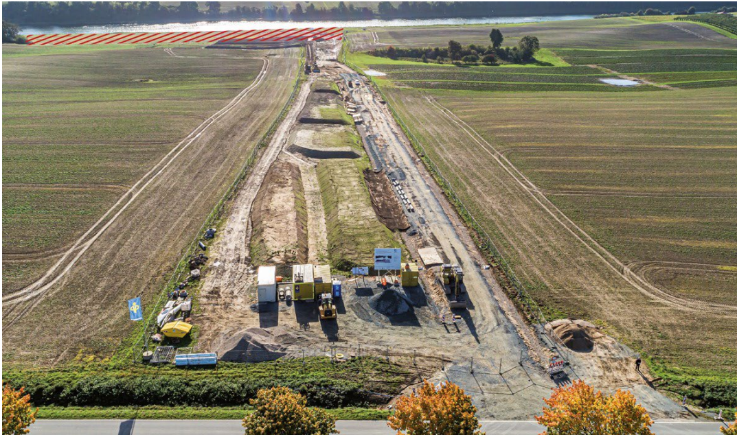
Neue Baustraße zwischen K 90 und der Ablagerungsfläche Warleberg Süd. Im Hintergrund ist, rot schraffiert, der Standort des zukünftigen temporären Schiffsanlegers eingezeichnet.
