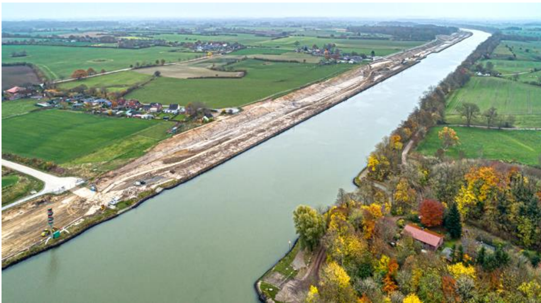
Bodenabtrag bis auf die Höhe des Wasserspiegels des Nord-Ostsee-Kanals (Blick von Kleinkönigsförde nach Osten)
