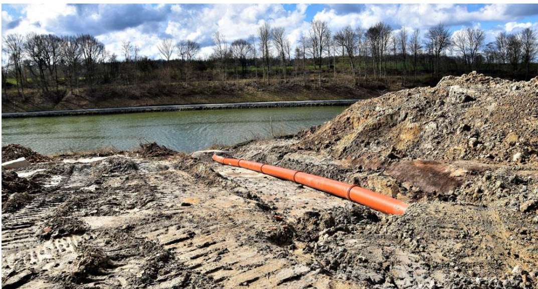
Provisorisches Entwässerungsrohr (für die Zeit, bis das Drainagesystem in der neuen Kanalböschung fertiggestellt und angeschlossen ist)
